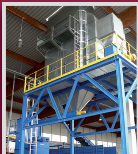
IMPIANTO DI FILTRAGGIO PER L'UNITÀ DI DEPOLVERAZIONE DI UN IMPIANTO DI SELEZIONE
