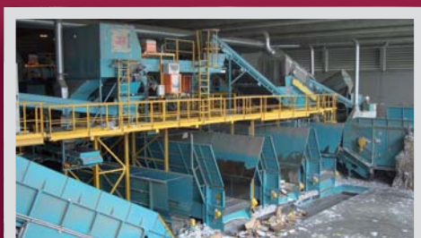
IMPIANTO DI SELEZIONE DELLA CARTA CON UNA RESA DI CA. 50 T/H
